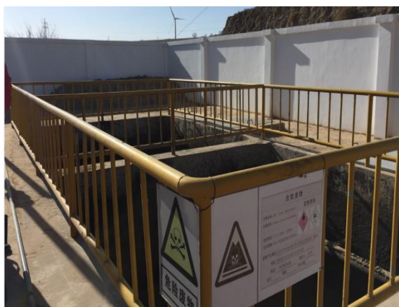
华二集输站内污油池
