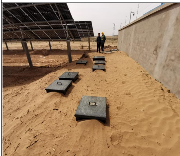
地理式污水一体化处理设施
