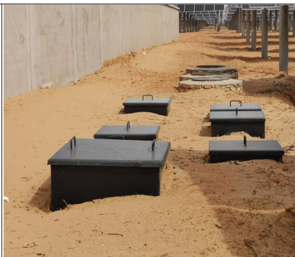
化粪池、隔油池、污水一体化处理设施 的位置
