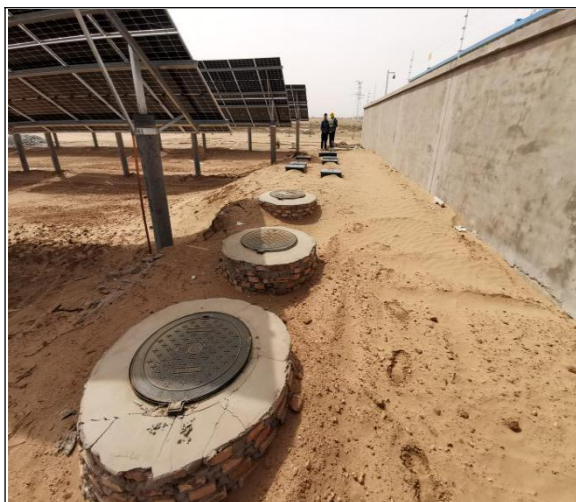
运维人员生活、办公区配备的化粪池、 隔油池
