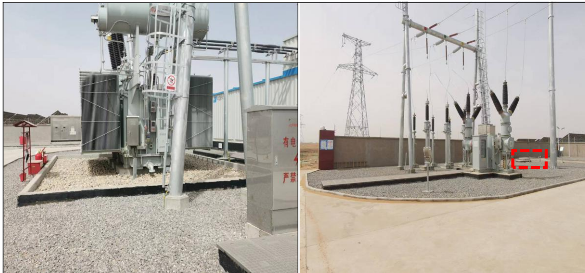
变压器底部储油池
